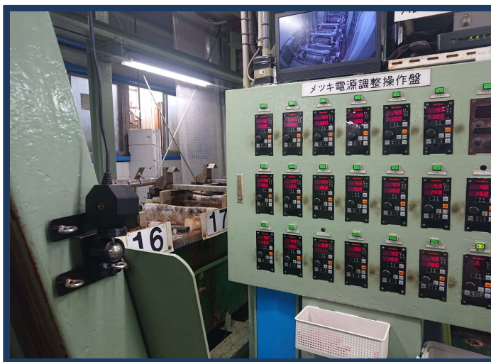
メッキ電源調整操作盤 (16ch)
